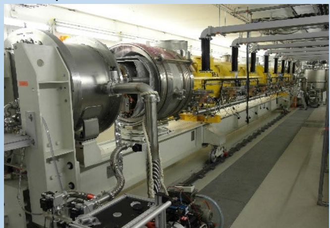
Cryomodule test stand – module inside
